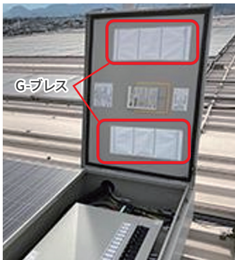
太陽光発電設備
